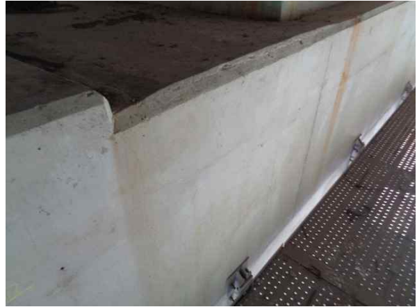
P2 콘크리트 망상균열 (8.0m×1.0m)
