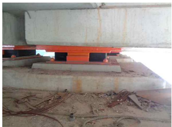
P1-Sh11 무수축물탈 균열 (0.1mm/0.2m)
