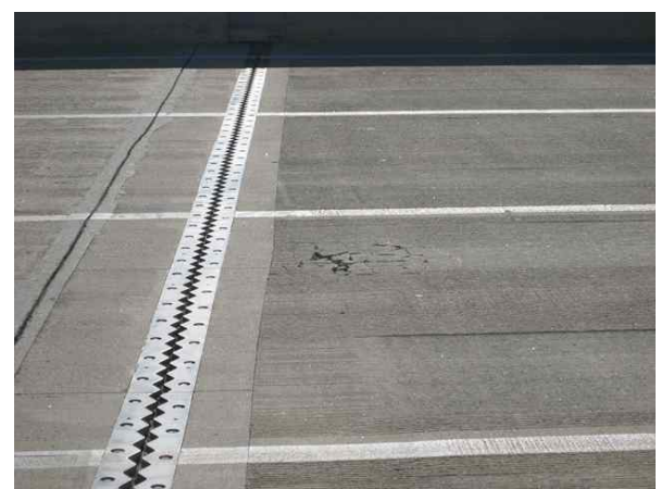
S1 포장 파손(1.0m×1.0m)
