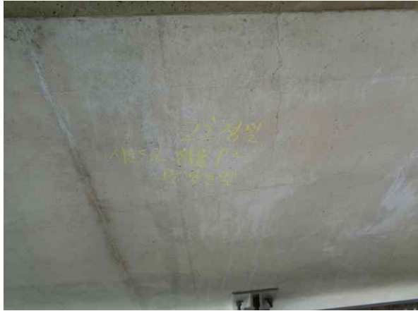
P2 콘크리트 망상균열 (6.0m×1.0m)
