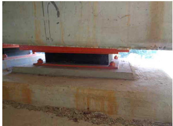
P1-Sh8 무수축물탈 균열 (0.1mm/0.2m)
