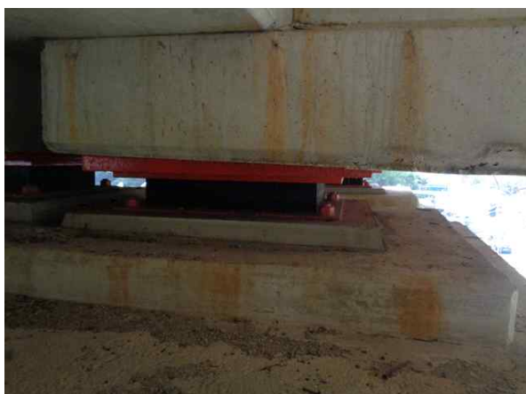
P1-Sh9 무수축물탈 균열 (0.1mm/0.2m)
