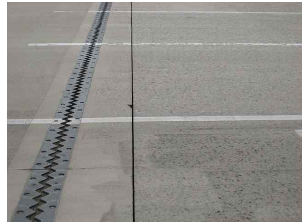
A1 후타재 파손 - 22년 상반기
